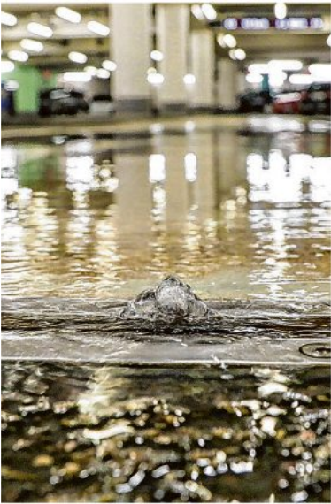
Grundwasser sprudelt aus der beschädigten Dichtung in der Tiefgarage des Parkhauses Kocherquartier heraus. Foto: ars
